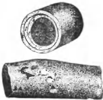
Рис. 2.78. Отдулины на печной трубе
