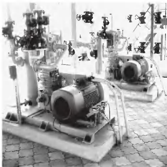
Рис. 2.212. Вид компрессорной установки
