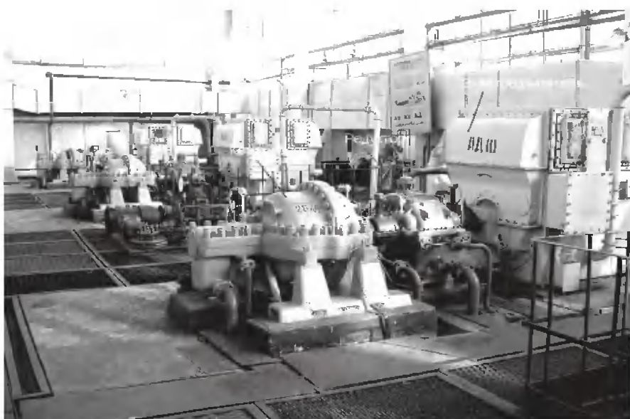
Рис. 2.213. Внешний вид компрессорной установки
