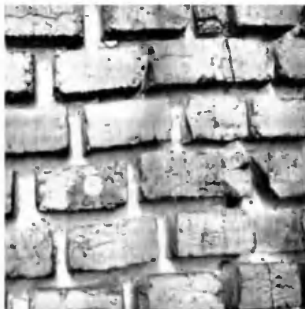
Рис. 2.95. Выветривание раствора кирпичной кладки
