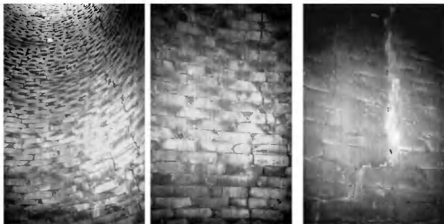
Рис. 2.96. Вертикальные трещины с раскрытием шва
